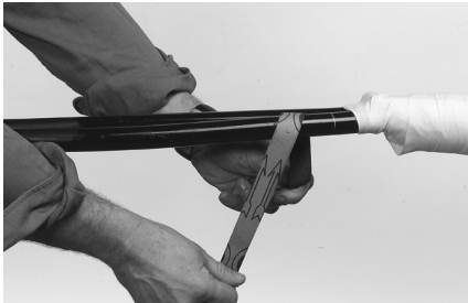
4.4 Rugga upp kabelmanteln med smärgelduk, från svepändans markering, och 200 mm ut på kabeln.
